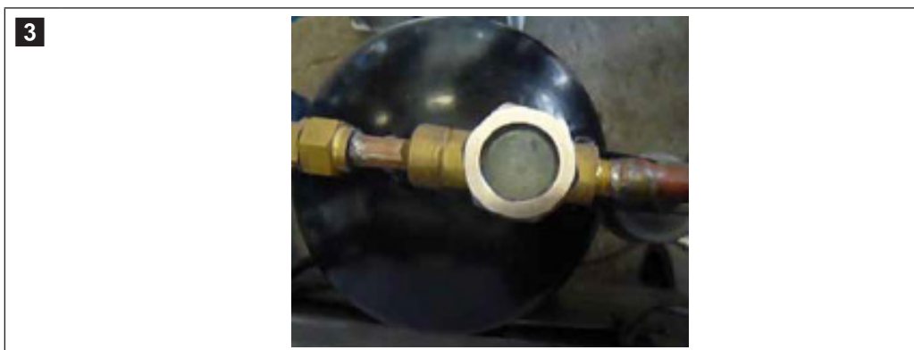
Abb. 3: Schauglas vom Spülbehälter der A/C Servicestation
